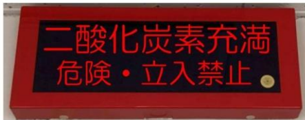
ガス消火剤放出表示灯
