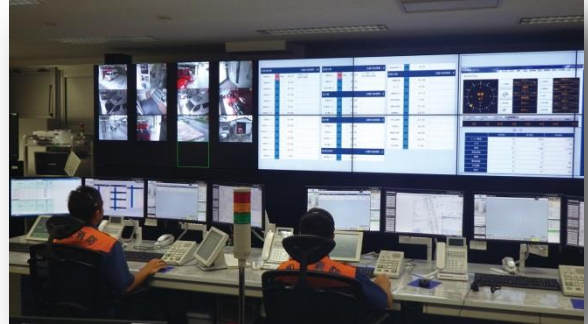
●消防指令センター
