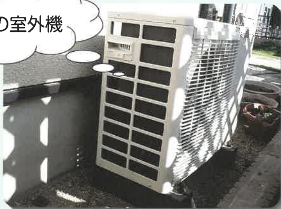
給湯器のまわり
