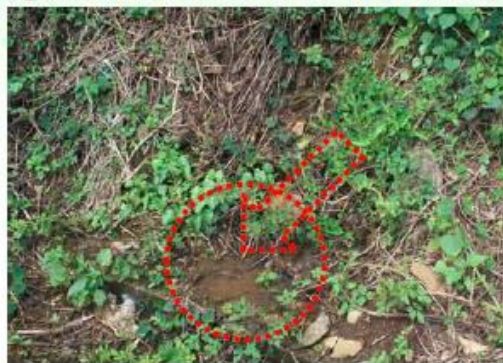
④ 染みだしやパイピングによる漏水
