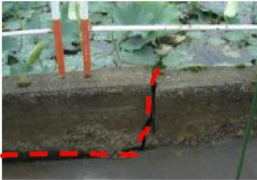
基礎ブロックの破損
