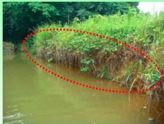
② 堤体の著しい浸食
