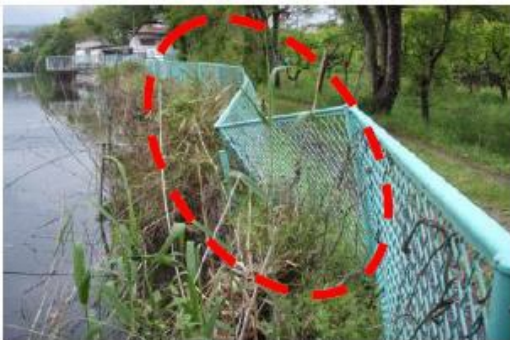
ネットフェンスの転倒
