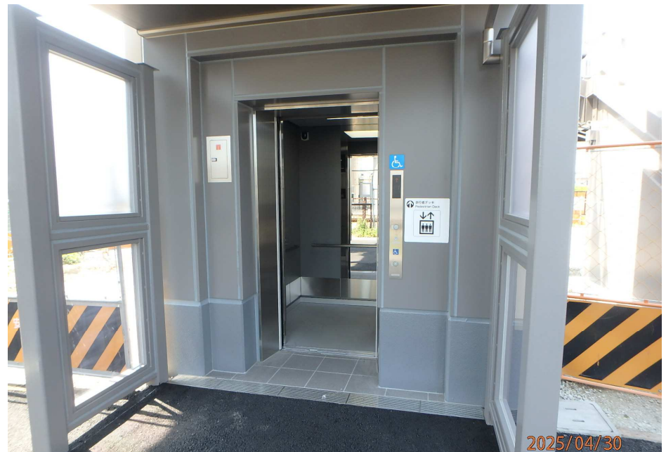
4 エレベーター（15人乗り）
