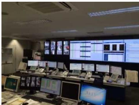
高機能消防指令システム
