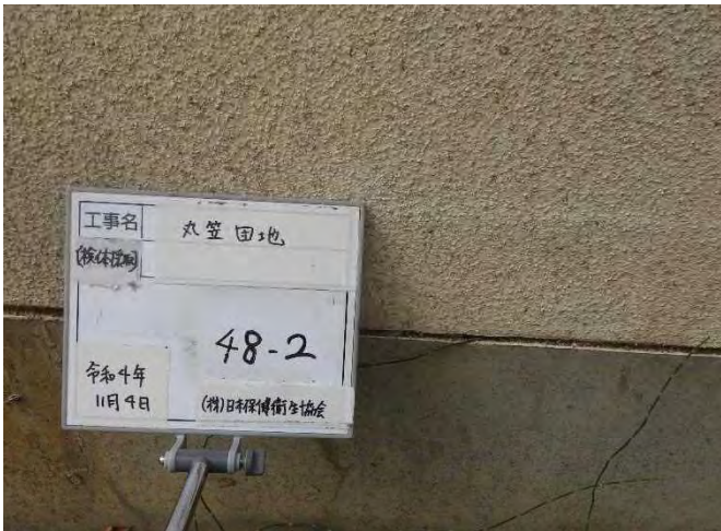
試料No.48 (採取前) 丸笠田地 4 棟 外壁 仕上塗材
