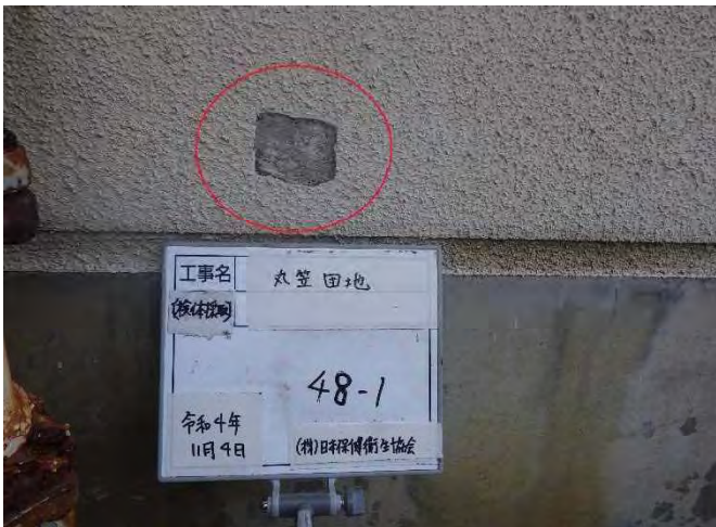
試料No.48 (採取後) 丸笠田地 4 棟 外壁 仕上塗材
