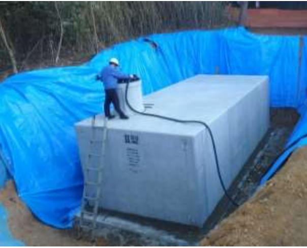
⑥防火水槽（東側エリア）
