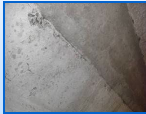
コンクリートのはくり
