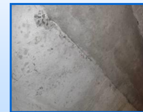
コンクリートのはくり
