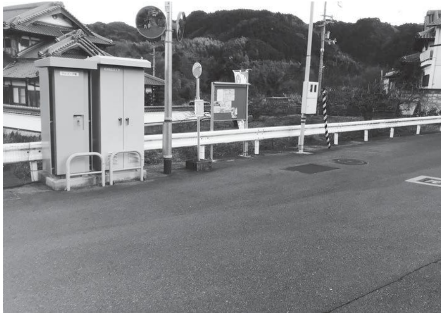
九鬼加圧ポンプ所
