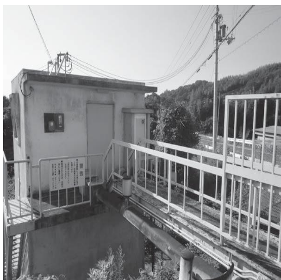
善正加圧ポンプ所
