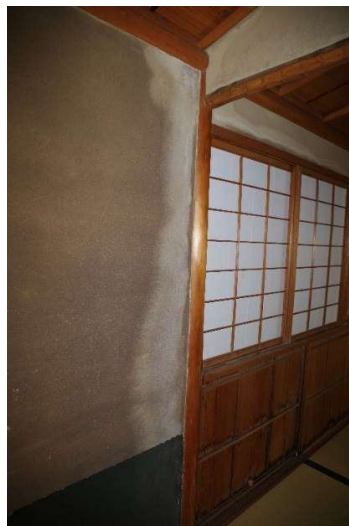
畳廊下 東側土壁の雨染み
