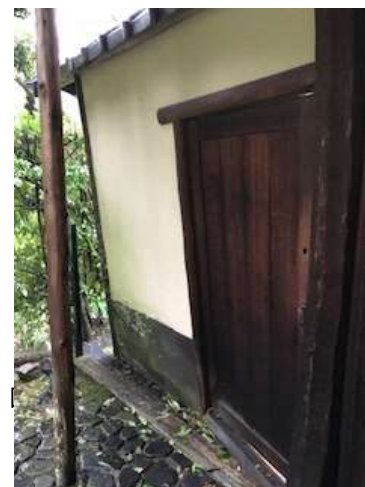
正門 袖壁 台風による傾き
