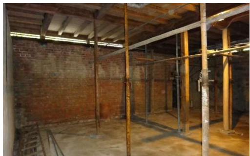
地下室 パイプサポート
