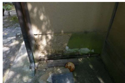
厨房 勝手口袖壁 土壁剥落・汚損
