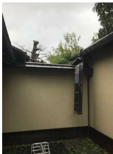
玄関横 壁 台風による銅板剥れ
