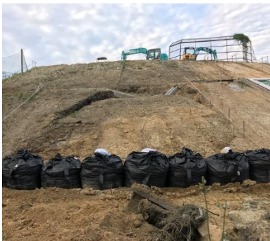
写真1 グラウンド法面の土砂崩れ
